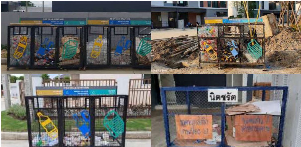
จัดทำจุดรวมขยะและคัดแยกขยะภายในพื้นที่ก่อสร้างของโครงการ
